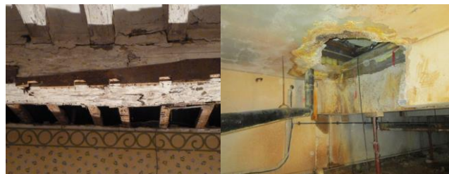
Poutre béton armé dont l'acier a fondu
